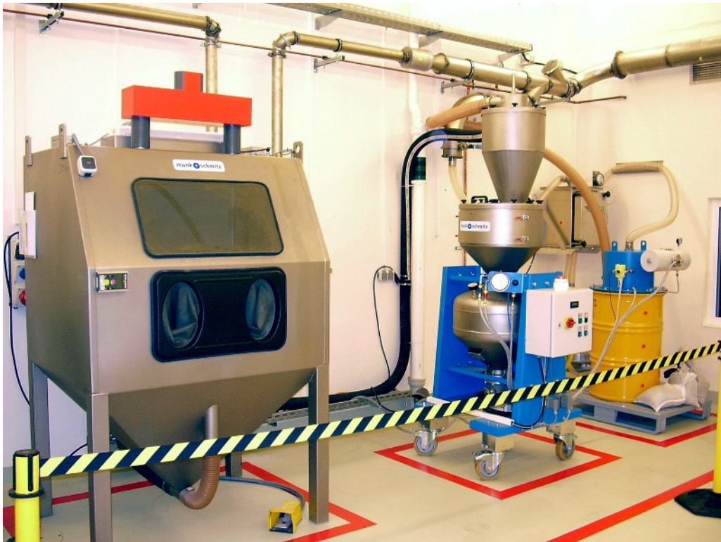
Abbildung 2-12: Dekont-Strahlanlage im Großen Bleizellenraum
